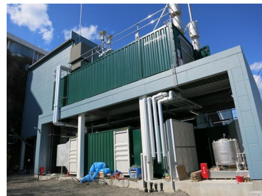
(木質バイオマス発電プラント)
